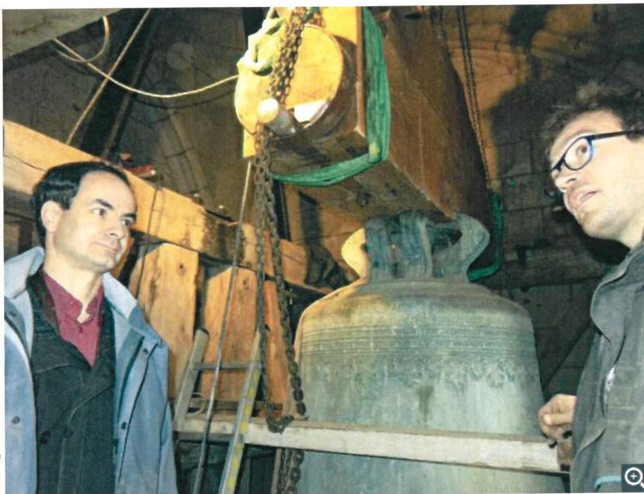
Jean-Pierre Crémier (à g.) suit l'évolution des travaux effectués par l'entreprise d'Alexandre Gougeon. Le nouveau joug en bois est déjà positionné au-dessus du bourdon.
